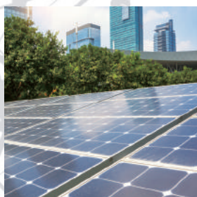
태양광 태양광 발전기
